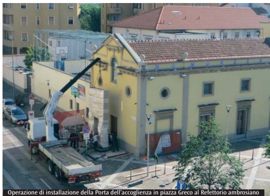
Operazione di installazione della Porta dell'accoglienza in piazza Greco al Refettorio ambrosiano
