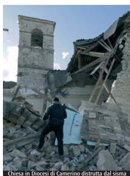
Chiesa in Diocesi di Camerino distrutta dal sisma
